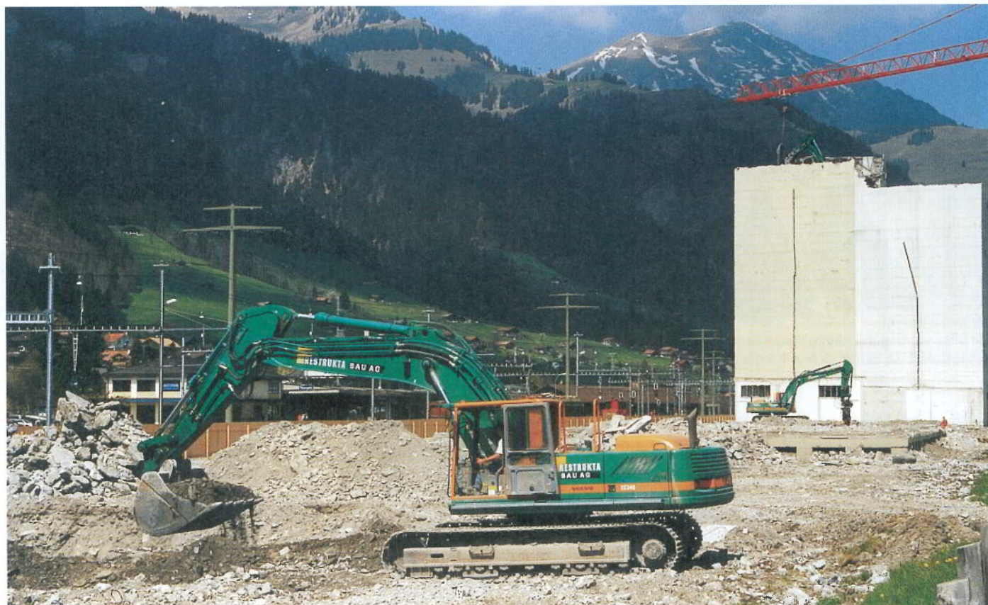
Während zwei Hydraulikbagger mit Hochdruck am Rückbau der dem Silo vorgelagerten Lagergebäude arbeiten, steht ein dritter auf dem ursprünglich 40 m hohen Silo im Einsatz.
