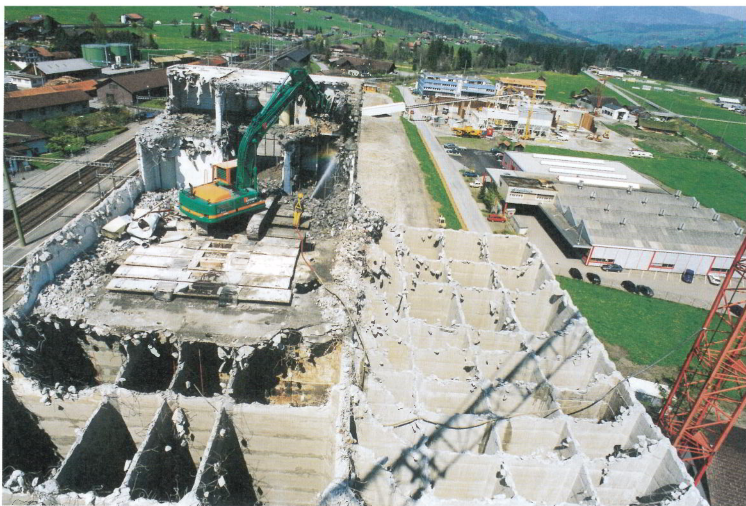
Die Silos werden mit einem speziellen Hydraulikbagger, stufenweise von oben nach unten abgebaut. Der Bagger, welcher mit Rückbauwerkzeug ausgestattet ist, beisst sich in 1,5 bis 2 m hohen Etappen in die Tiefe.
